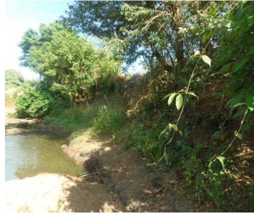
Figura 13.2 – Erosão na margem
