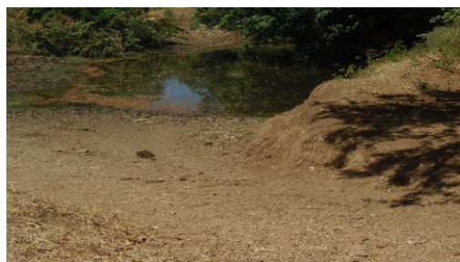
Figura 19.2 – área de erosão no final do trecho
