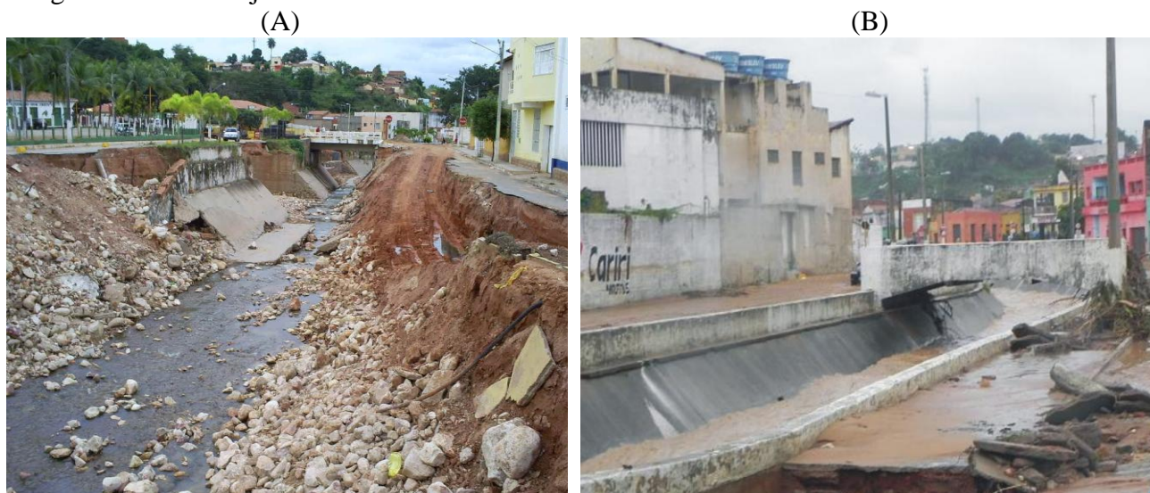
Figura 49: (A) Danos causados pela inundaç o do canal do Rio Granjeiro; (B) Ocupa es ilegais as margens do Rio Granjeiro no Crato.
