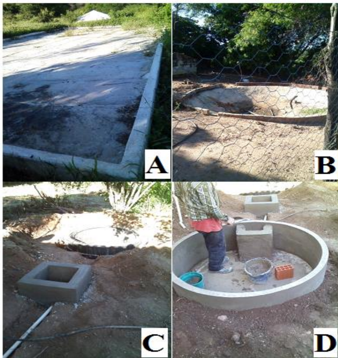
A – Cisterna Calçadão; B – Reservatório da Mandala de produção integrada de alimentos; C e D – Sistema de captação e reutilização da água de pias e do banho.
