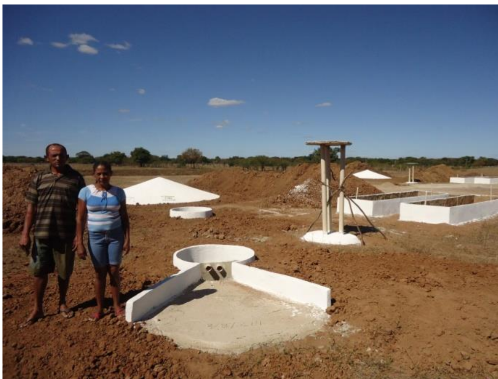
Figura 2: Cisterna de enxurrada e canteiros econômicos de alvenaria
