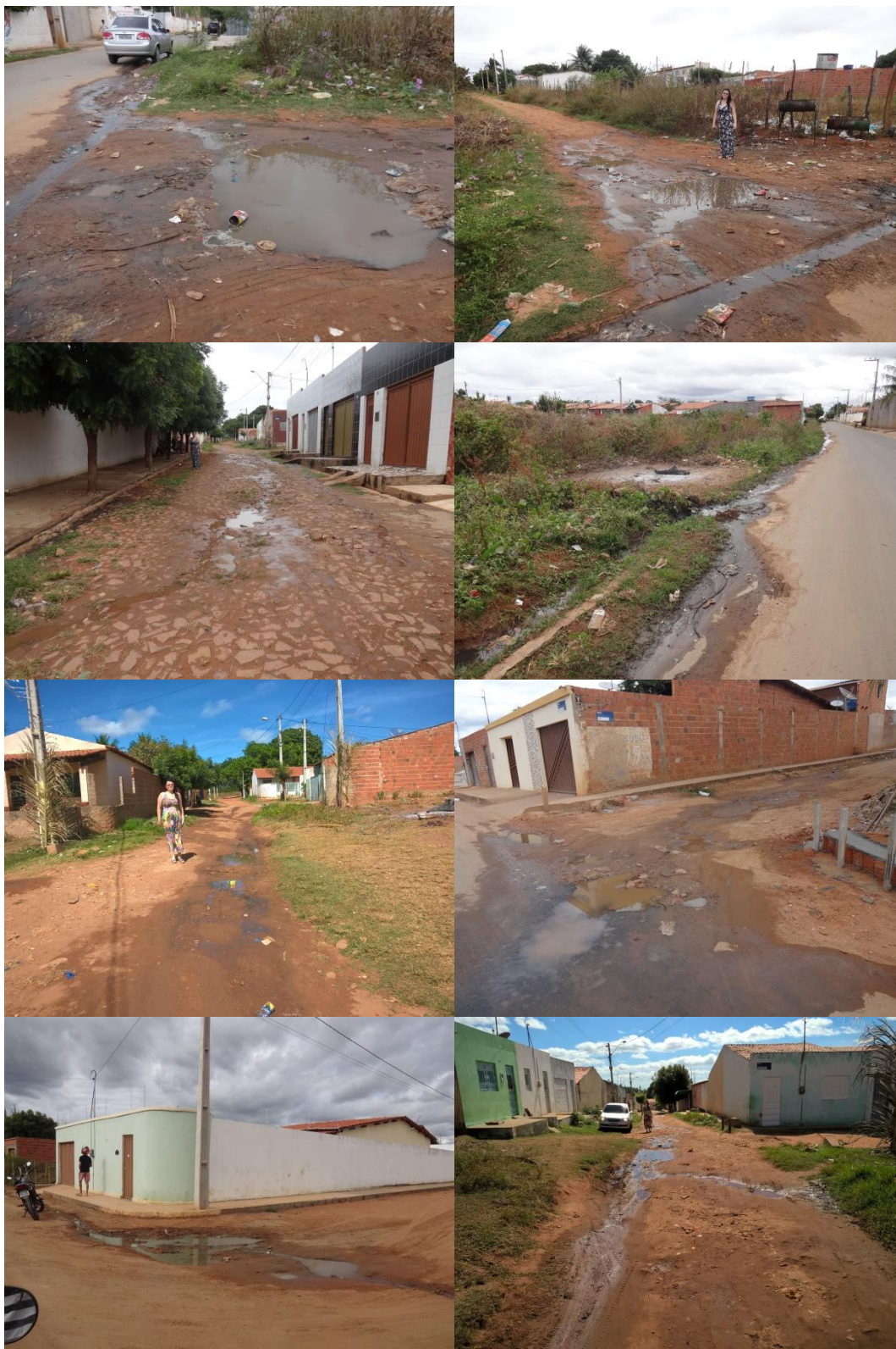
Figura 40- Imagens dos esgotos em várias ruas do bairro Brejo Seco
