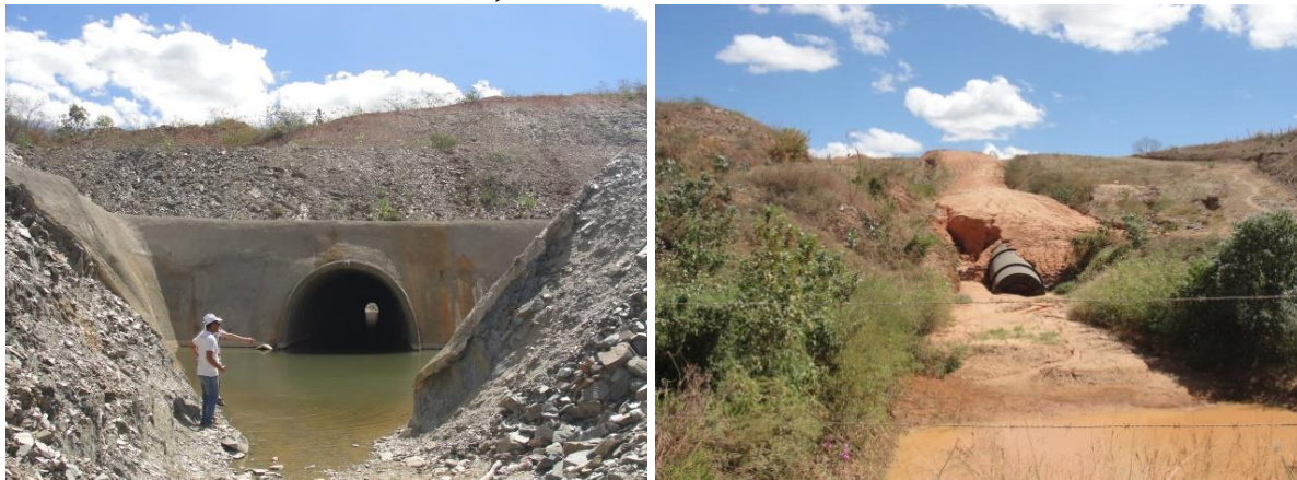
Figuras 18 e 19 – Água acumulada no Túnel Carnaúbas no Assentamento 10 de Abri e erosão e assoreamento ao lado do sifão Pai Mané, Crato
