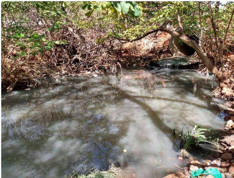
Figura 10. Lançamento de águas cinzas por meio da galeria pluvial na Lagos dos Macacos.
